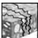
Бетон (с трещинами)
