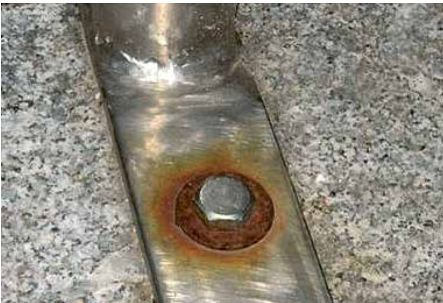
Рис. 12: Типовий випадок контактної корозії. Використано цинковану (електрооцинковану) сталеву шайбу та нержавіючу сталь (гвинт і деталь). Площа поверхні більш благородного металу — нержавіючої сталі — є більшою, через що інтенсивно кородує шайба.
